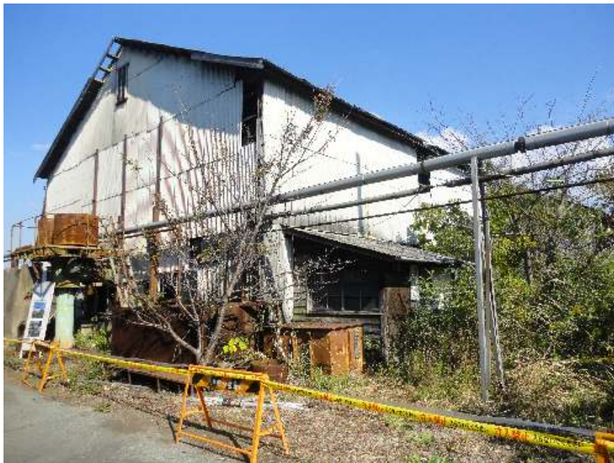
写真4 コンプレッサー室
